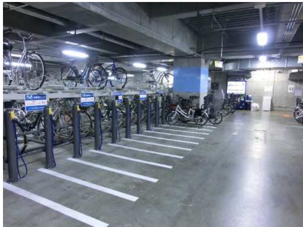
大型自転車駐車スペース
